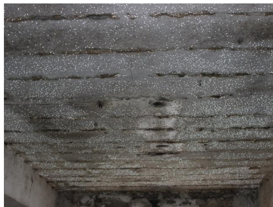
Foto 1. Pohľad na strop ustajňovacieho objektu pre bahnice v zimnom období. Strop pokrytý vodnými kvapkami padajúcimi na zvieratá (Foto Tančin 2018)
