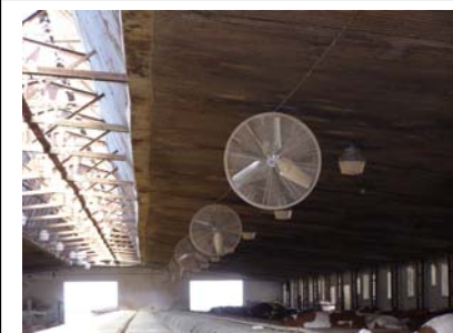
Veľkoplošné ventilátory podporujúce prúdenie vzduchu v maštali
